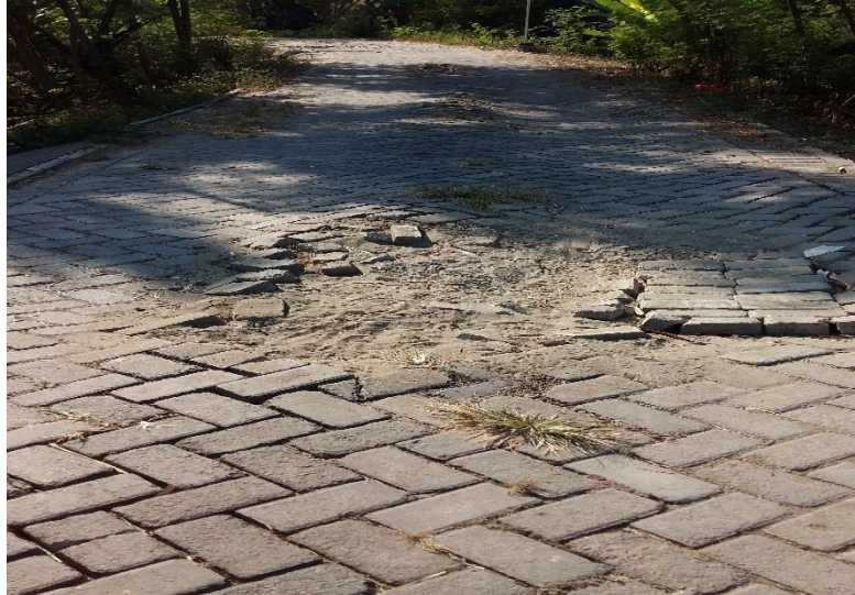
Gambar 4.4 Kondisi Jalan Desa Bulutigo
